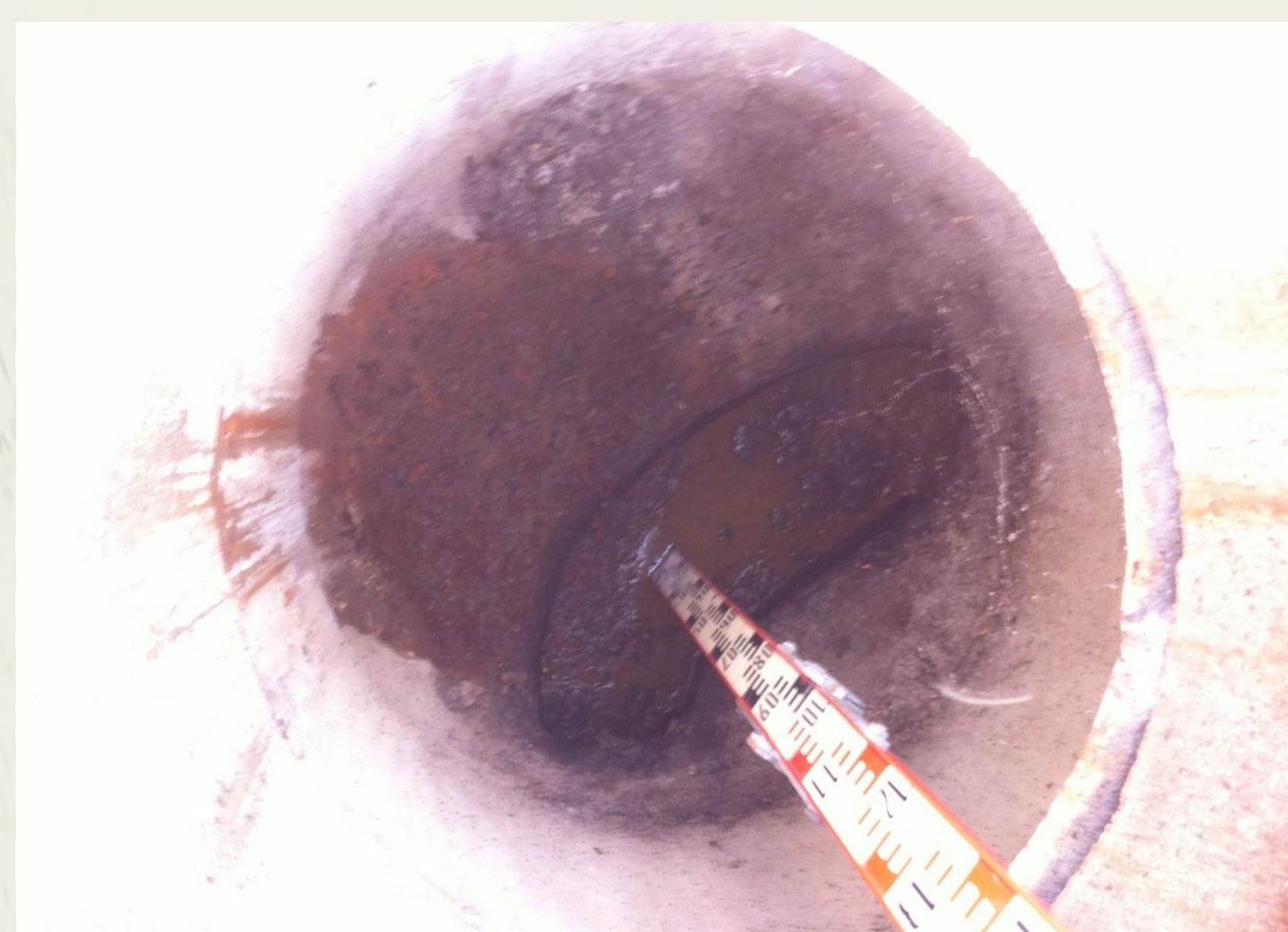
Figur 8 Måling af bundkote i brønd med kraftig slamaflejring i bundløbet
