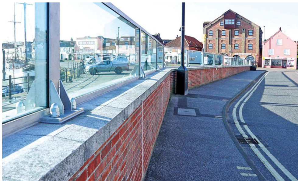
Højvandsmur bestående af mur og glasvæg. Foto venligst udlånt af Dansk Stormflodsikring
