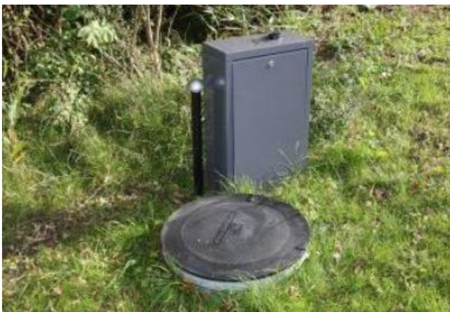
Fig. 5. Tilsendt fra ansøger. På figuren ses et eksempel på den type el-skab der etableres i tilknytning til dækslet af husstandspumpestationen på matr.nr. 8ac og 11b.
