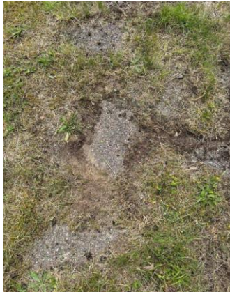
Ælder belægning frilagt
