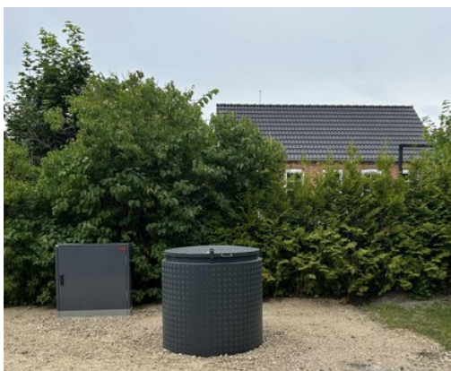
Eksempel på pumpestation
