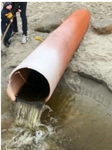
Fig. 2 Medsendt foto af rørudløb.
