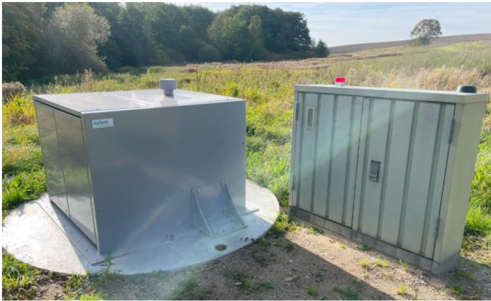
Eksempelfoto af ventilskab (til venstre) ved elskab (til højre).
