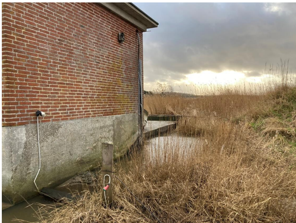
Figur 3-20 Vestsiden af pumpehuset, hvor diget også er delvist borteroderet.
