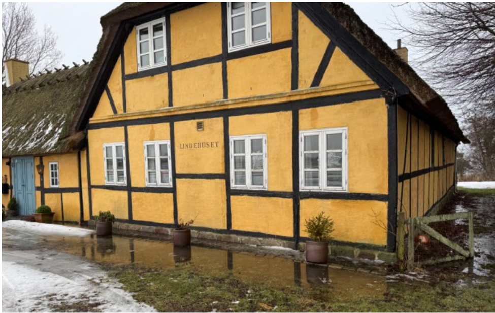
Fig. 8. Tilsendt fra ansøger. Billede af boligens vestlænge, hvor man kan se husets sokkel.
