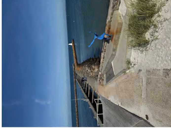
Figur nr 2 Foto af eksisterende Østre mole taget den 3. juni 2025 i tidsrummet 9:30 til 10:30 med en vandstand Bogense højvandsmåler på 4-6 cm over dvr90. Fotos taget af Kyst-havneviden
