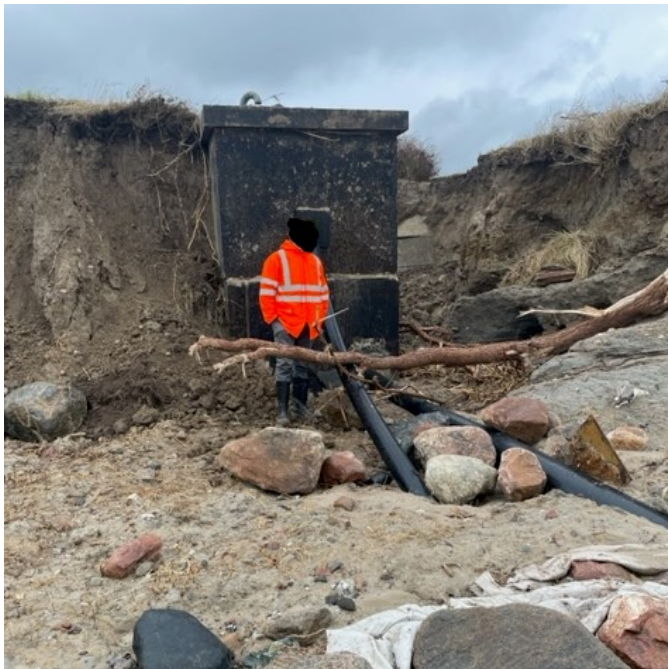
Foto viser, at det eksisterende bygværk er blotlagt på stranden på grund af erosion af kysten.
