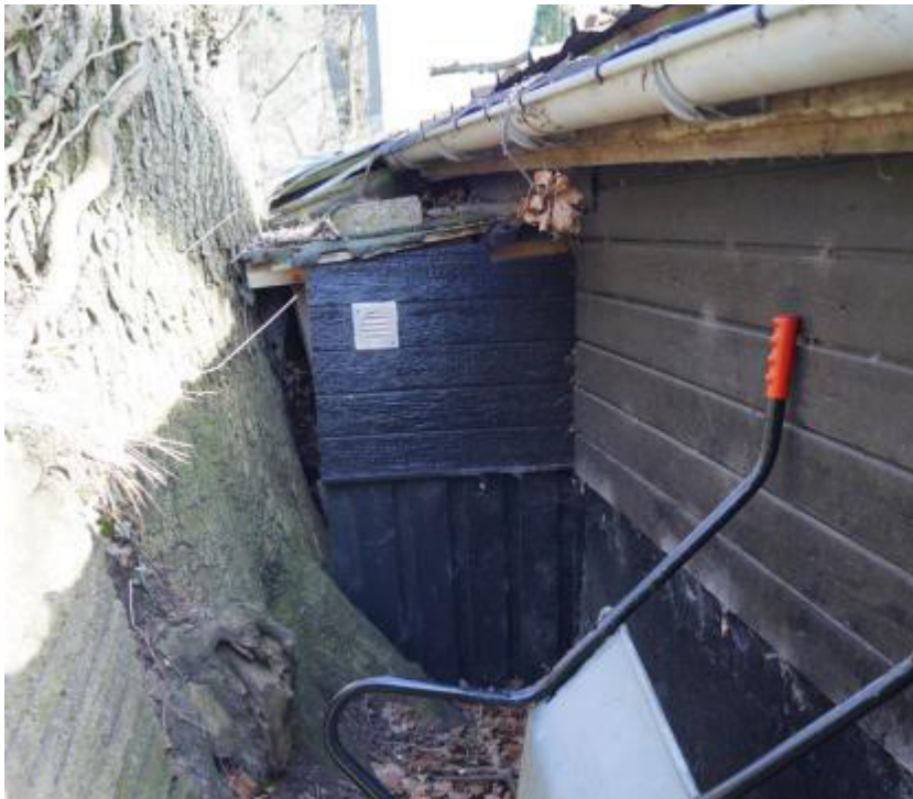
Foto fra besigtigelse, hvor det lille skur. Presenningen ses i baggrunden.
