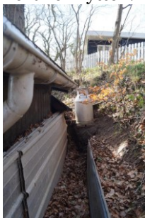
Foto fra besigtigelse 2017, der viser mælkejunge på støttemuren.
