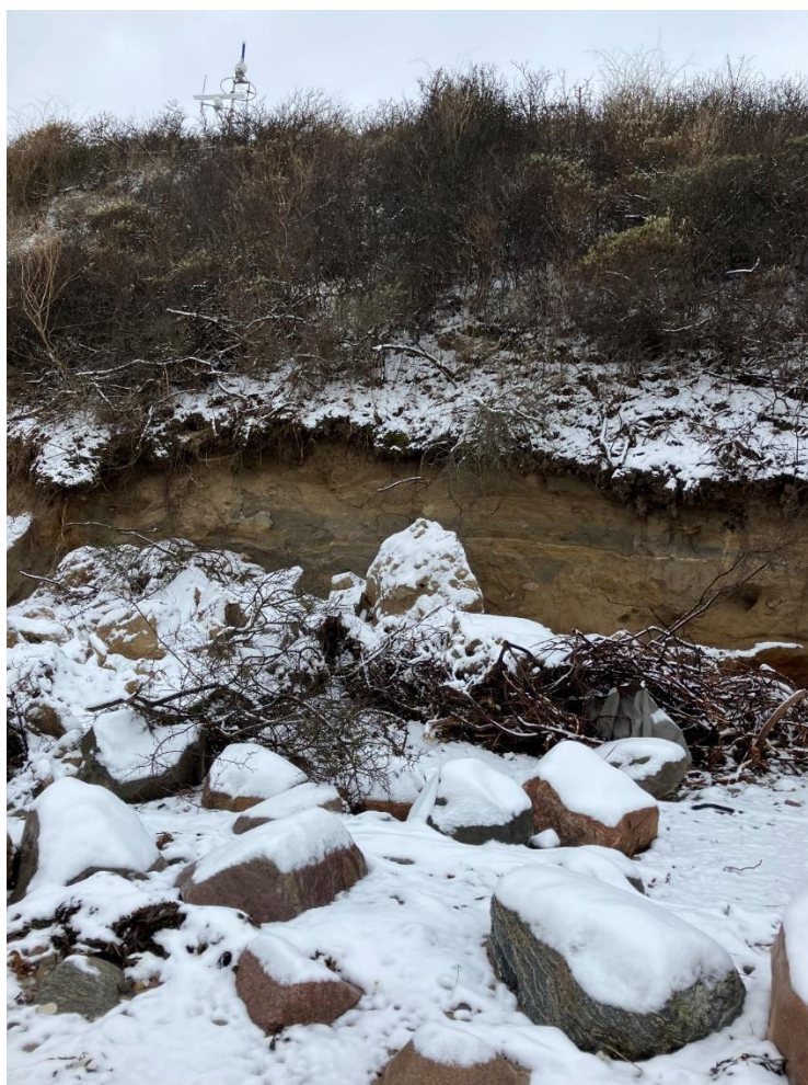
Figur 5 - Skred ud for bygning. Skrænten består af ler.
