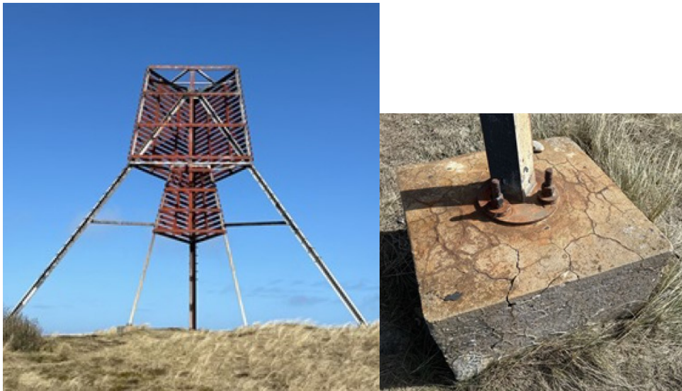
Vigso Båke. Punktfundamenterne ved Vigso Båke er udtjente og skal skiftes.
