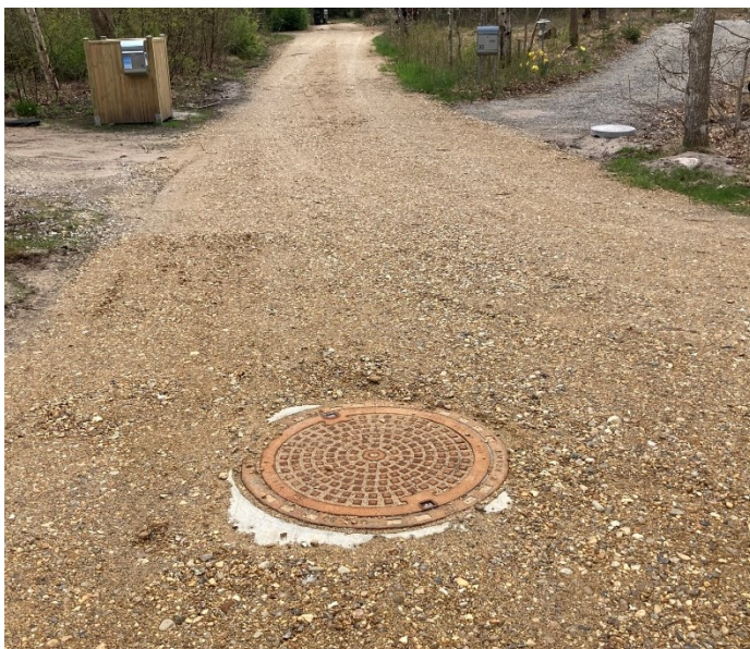
Fig. 4. Billede tilsendt fra ansøger, hvorpå man kan se hvordan dækslet på en pumpestation vil se ud.
