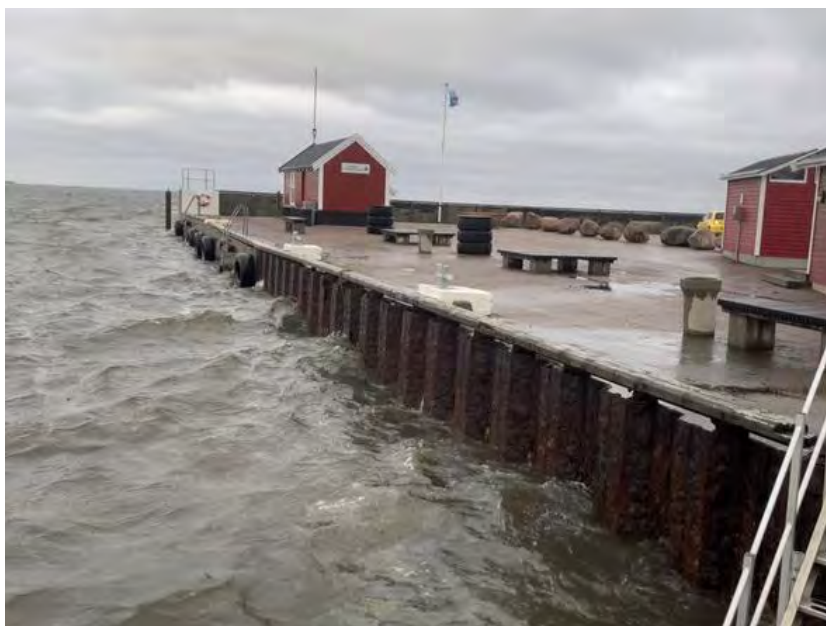
Figur 2 – Udvendig vestlig side af Havnsø havn, her ses stålspunsen på den inderste del som står med store skader og begrænset restlevetid.
