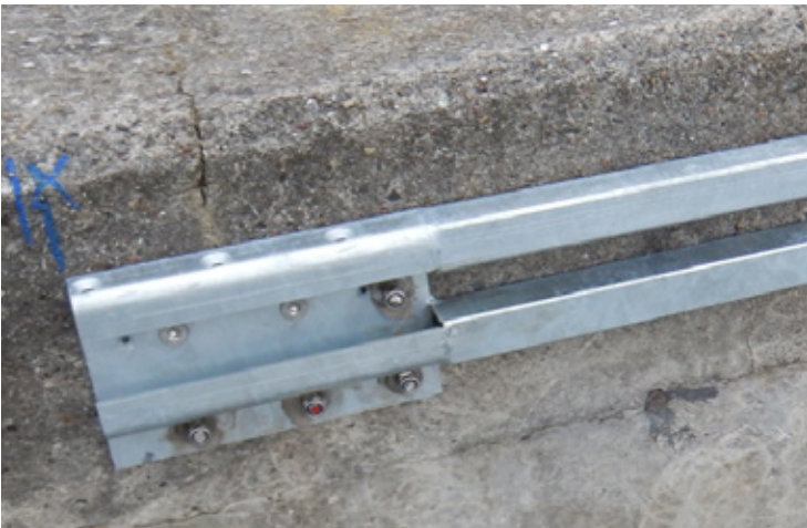
Reference - Fastgørelse i kajmuren
