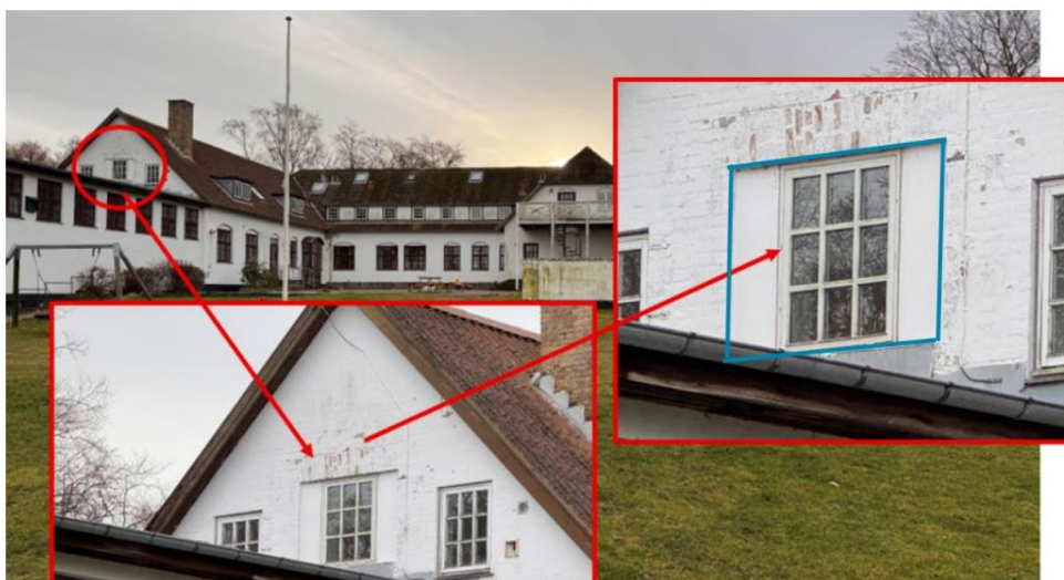
Fig. 6. Billeder indsendt af ansøger som viser det vindue i hovedbygningens ene nordgavl, som ønskes udvidet. Omfanget af det nye vindue efter udvidelsen er markeret med blå firkant.
