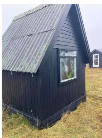
Gammelt vindue, der var råddent og med flækket glas. Dette vindue var ca 100cm bredt og ca 95 cm højt.
