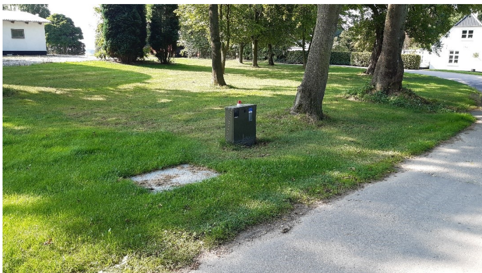
Billede 1: tilsendt fra ansøger, hvorpå man kan se et etableret dæksel og el-styretavle.
