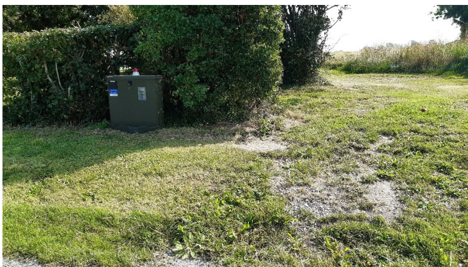
Billede 2: tilsendt fra ansøger, hvorpå man kan se et etableret dæksel og el-styretavle.
