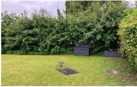
Figur 4: Eksisterende pumpestation på Hornsherredvej 192. Eltavlen ses i hækken bag hyndeboksen.
