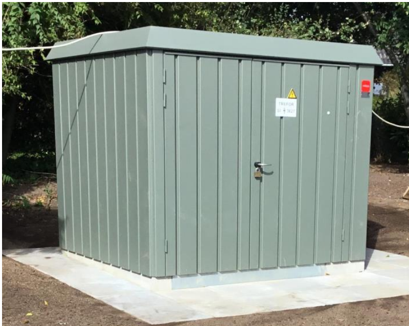
Eksemplarisk billede af den nye transformer-kiosk.
