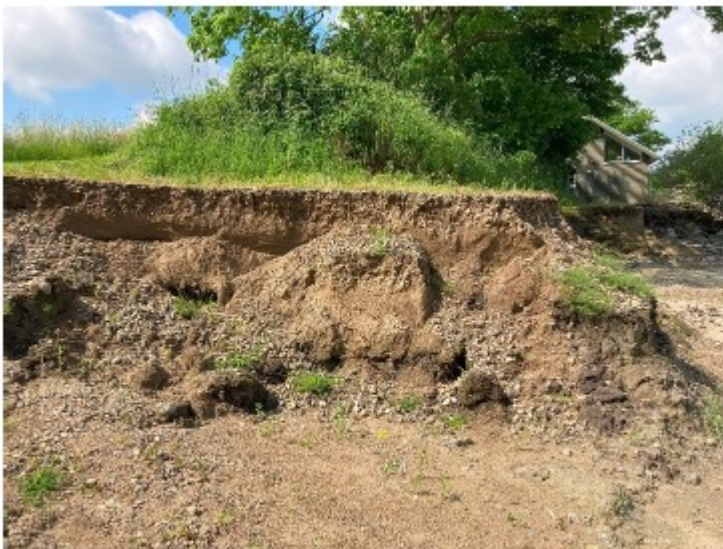
Nedkørsel til 527 bortskyllet.
