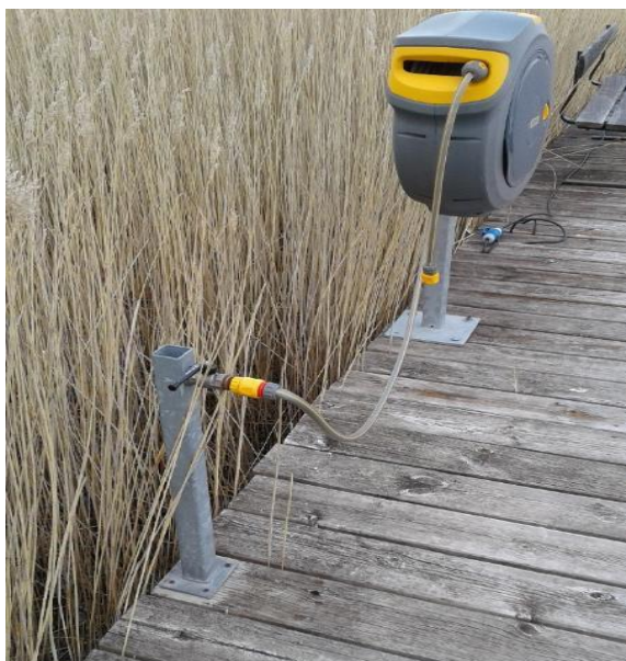
Fig. 21 Eksisterende aftapning med Hazelock slangevinde på Nordmolen
