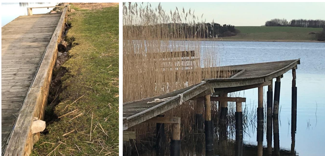
Fig. 3 Ødelæggelser i forbindelse med stormvejr i og ved Lyndby Havn
