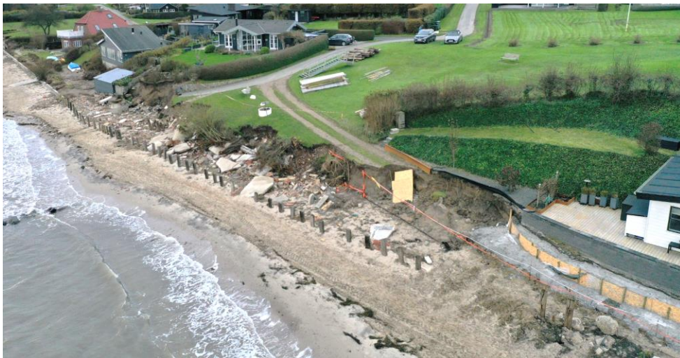
Oversigtsfoto fra ansøgningen, der viser hovedparten af den bortskyllede strækning med store skader på vejen.
