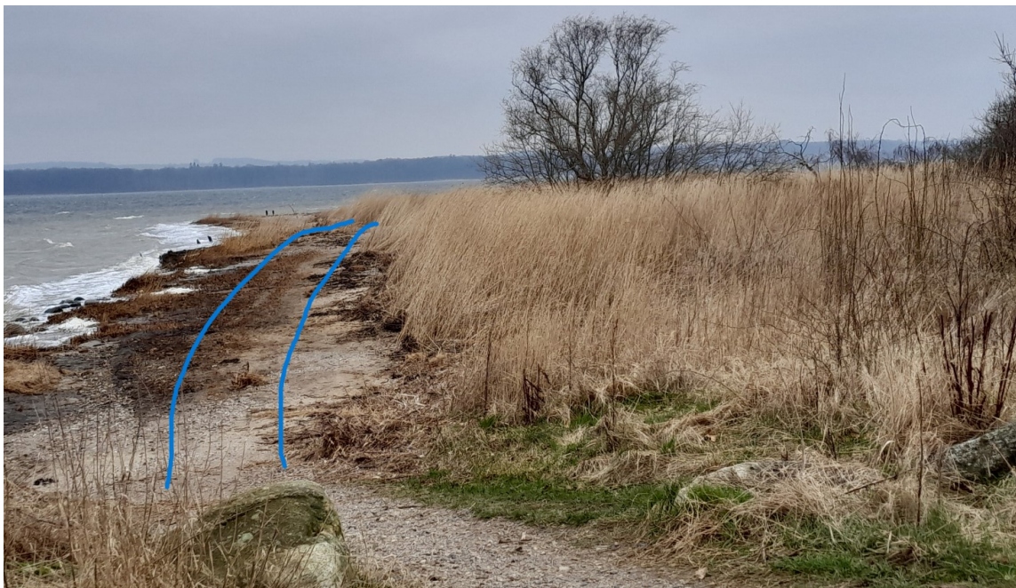
Foto viser omtrentligt forløb af den eksisterende sti, som er delvist eroderet i løbet af vinteren 2023/24. På den del af stien, der bliver tilovers i forbindelse med at den nye stistrækning etableres, vil grusmaterialet blive fjernet. Passagen vurderes af ansøger hurtigt at gro til, da både færdsel og drift af stien ophører så snart alternativet er etableret. Der vil derfor ikke være to parallelle stier på strækningen.
