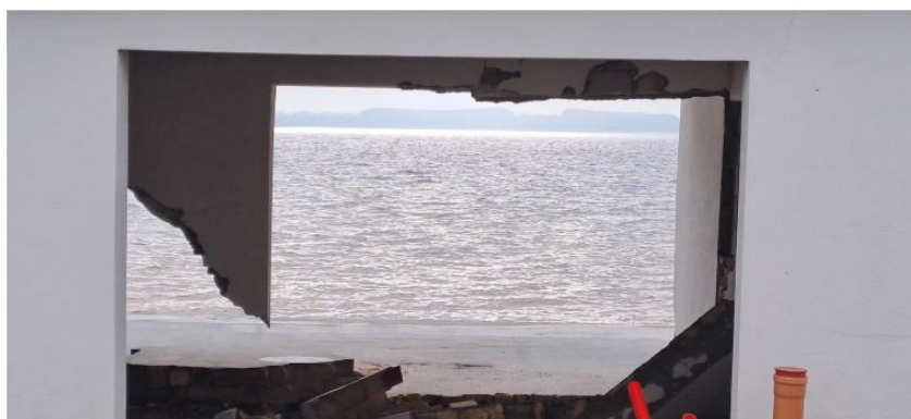
Fig. 8. Billede indsendt af ansøger som viser den ødelagte bagvæg i det eksisterende udhus.
