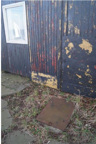
Foto fra besigtigelsen, der viser hullet med låget.
