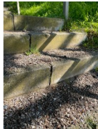
Mødet af betonsten i modten af stødrinnene.
