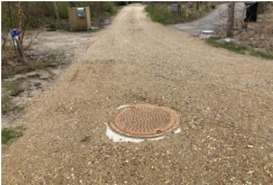
Kloakbrønd i vejareal
