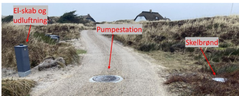
Pumpestation placeret i vejareal med tilhørende el-skab og skelbrønd
