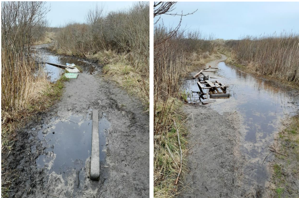
Fig. 12. Billeder tilsendt af Hjørring Kommune, taget den 22. marts 2024. Viser tilstanden af stien mellem Tversted Søerne og stranden, samt materialer lagt ud for at gøre stien farbar.
