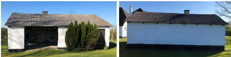
Fig. 2. Billeder fra ansøgningen af det eksisterende udhus. Til venstre ses facaden mod sydvest. Til højre ses facaden mod nordøst.
